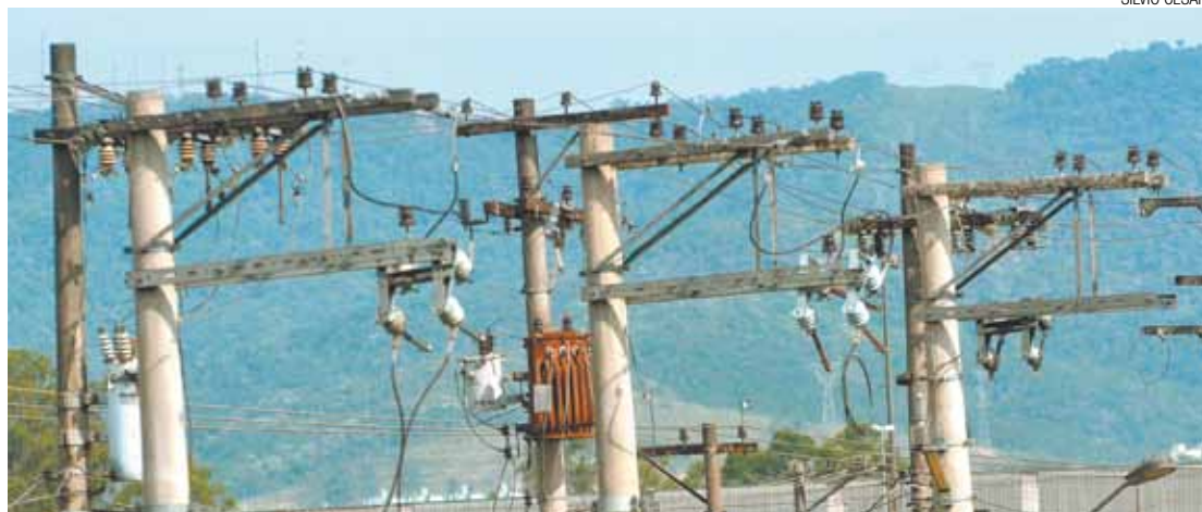
Transformadores - Falta de chuvas faz com que geração de energia elétrica fique mais cara que o normal
