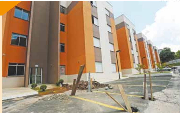
Atraso - Dezenove meses para a entrega e problemas estruturais
