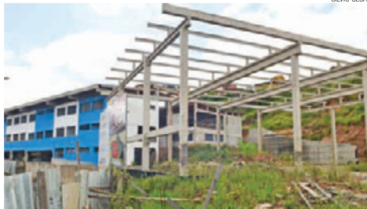
Perigo - No local há acúmulo de água, facilitando a proliferação de dengue
