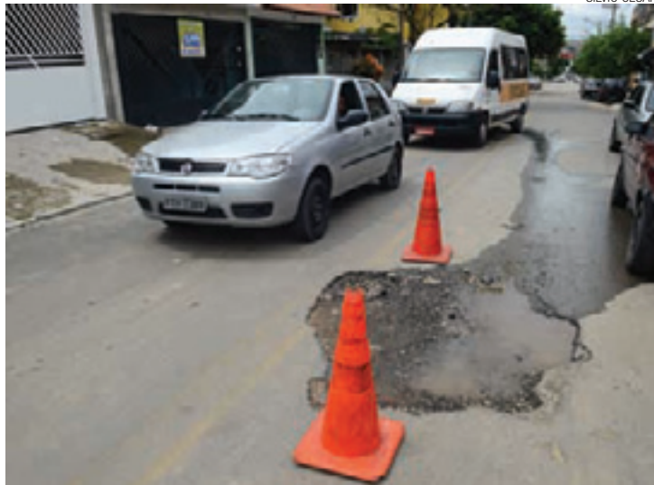
Buraco - Vazamento sinalizado com cone na Rua Capitão Zineu Simionato
