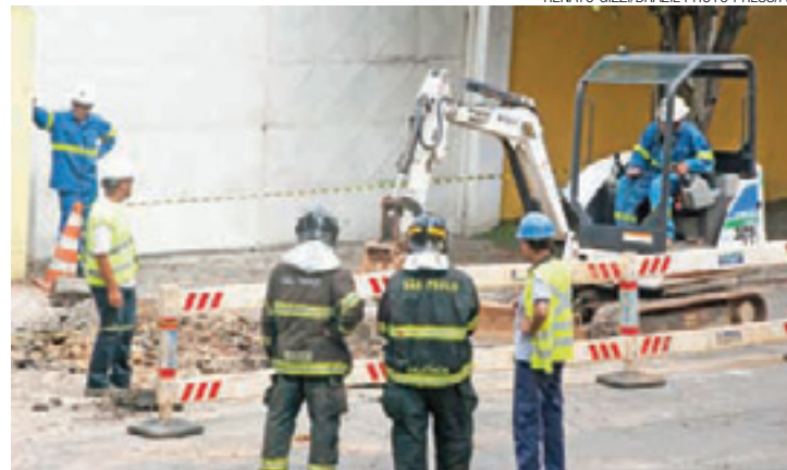
Susto - Rua onde ocorreu vazamento foi interditada pelos Bombeiros
