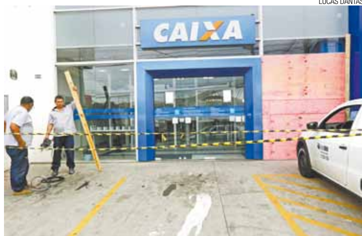
Prejuízo - Suspeitos arrancaram parede de vidro da agência bancária
