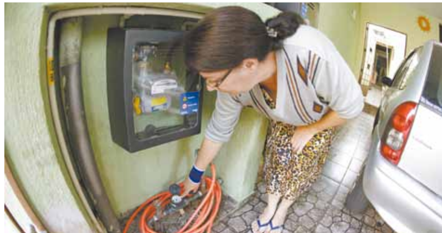
Na garagem - Algair aponta o hidrômetro completamente parado; água não chega
