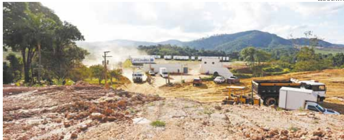
Descaramento - Caminhões circulam o dia todo pela região descartando entulho e lixo em aterro ilegal
