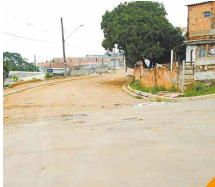
Quase lá - Limite entre terra e asfalto causa ira nos moradores
