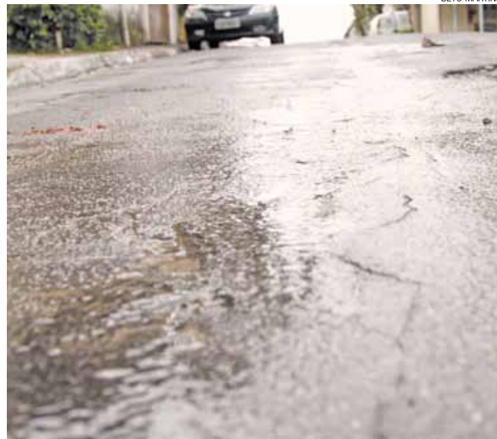
Desperdício - Água mina do asfalto o dia inteiro no meio da rua
