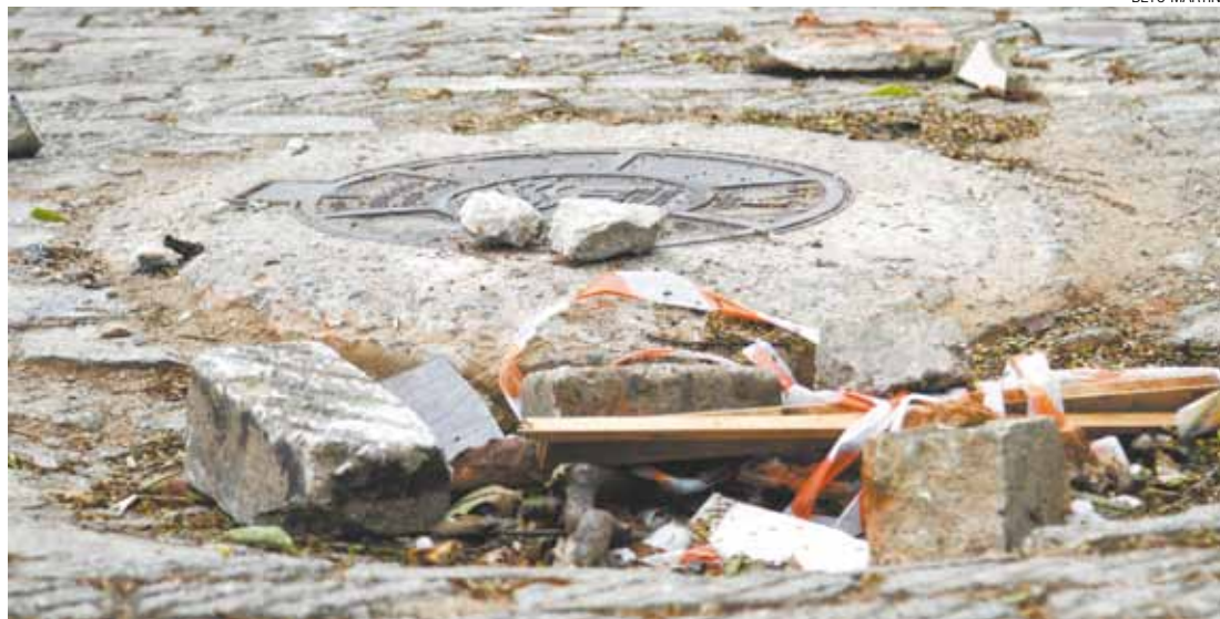
Resquícios - Pedra soltas e até uma fita de contenção ficaram na via após um serviço feito no tampão
