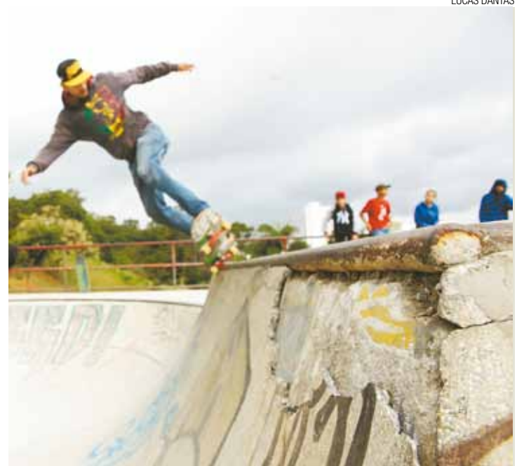
Rachaduras - A mini rampa do Bosque Maia tem pontos esburacados
