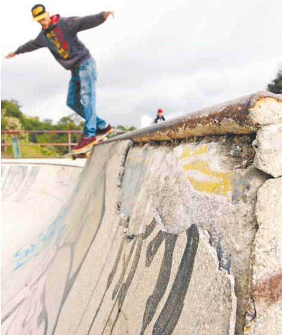
Skate - Rampa mais acessível de Guarulhos, que fica no Bosque Maia, está deteriorada
