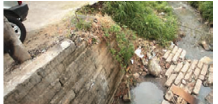
Córrego - Parte do que foi um muro de arrimo ainda está caída
