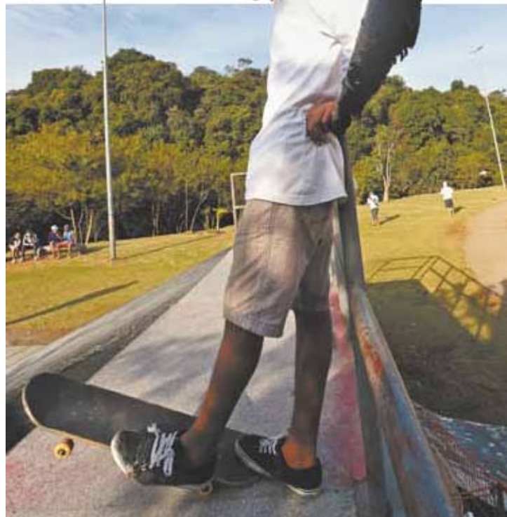
Sem condições - No Jd. Adriana, corrimãos da pista estão enferrujados
