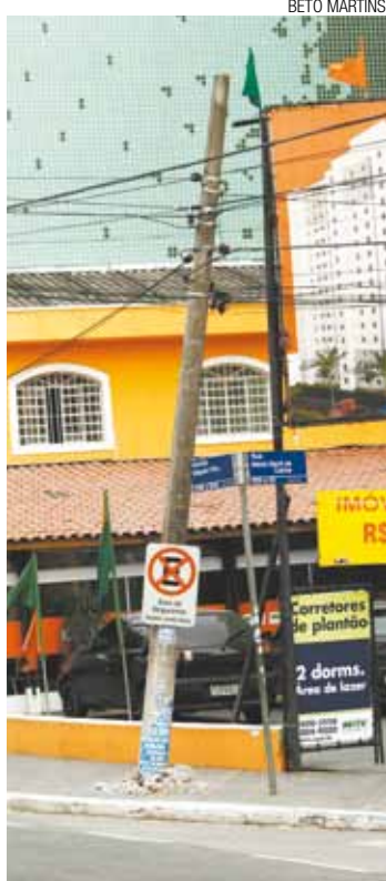
Perigo - Poste com risco de queda ainda aguarda conserto
