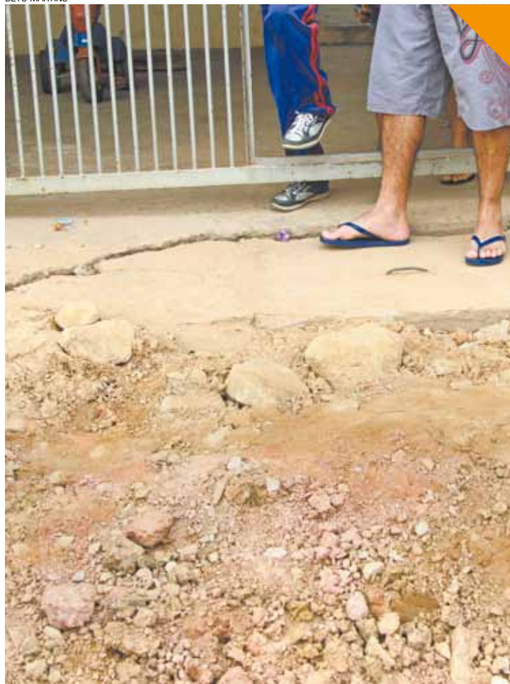
Estrutura abalada - Moradores precisam caminhar com cautela
