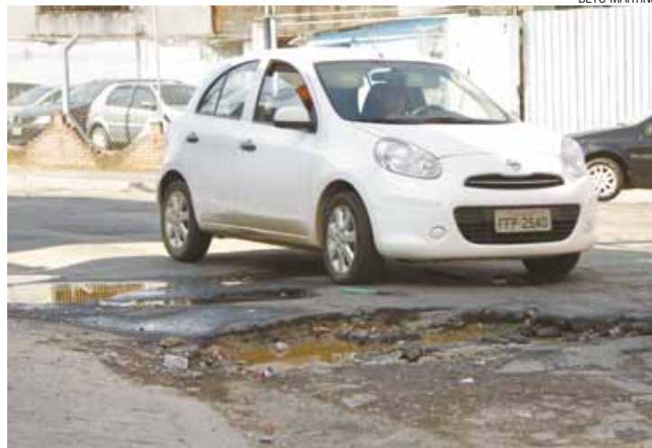
Risco - Buraco faz com que motoristas desviem à pista no sentido contrário
