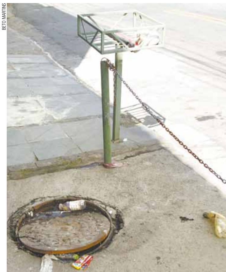
Perigo - Tampa de bueiro solta fica na calçada de um colégio particular
