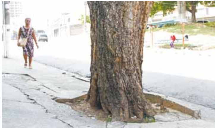
Risco - Base da árvore está oca; galhos são danificados por caminhões
