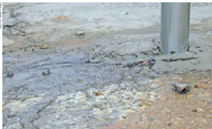
Desperdício - Cano perfurado “por engano” provocou grande vazamento
