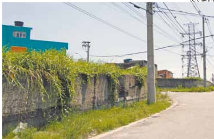
Sem manutenção - Descaso da empresa coloca moradores em perigo
