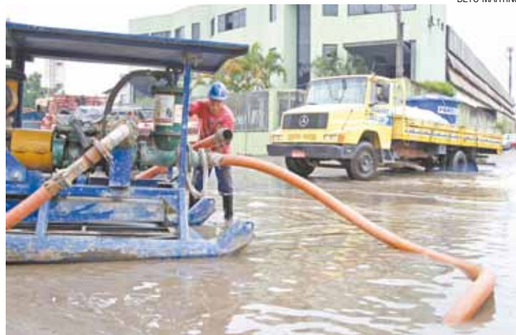
Bomba de sucção - Equipamento chega a retirar 5 mil litros de água
