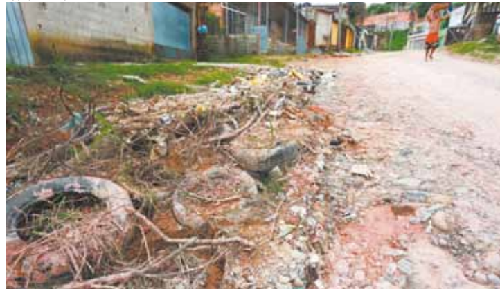
Proteção - Muro de arrimo é improvisado para tentar melhorar a via
