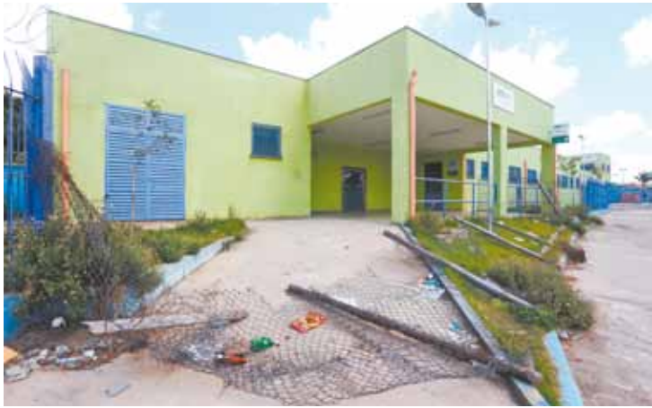
Abandono - Grades caídas na obra - atrasada - da UPA Cumbica
