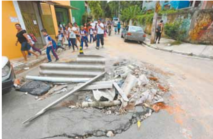
Obstáculo - Buraco fica entre as ruas Itai e Pindaí, no Jardim Oliveira
