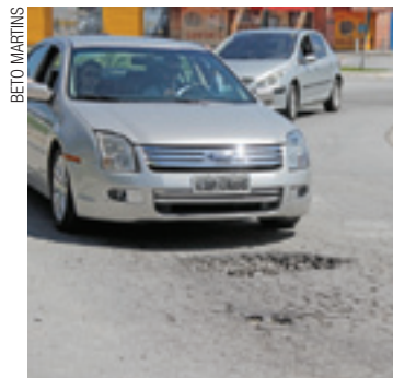
Buracos - Rachaduras na pista dão sinais de que podem crescer
