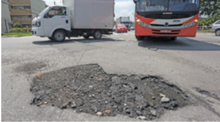
Obstáculo - Buraco que abre frequentemente prejudica a circulação
