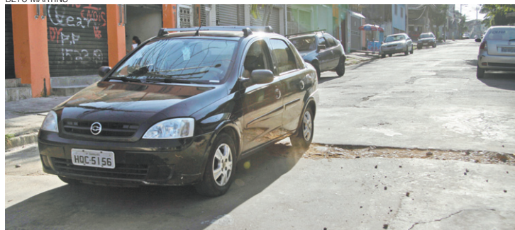
Incômodo - Buraco já atrapalha a circulação de veículos, diz moradora
