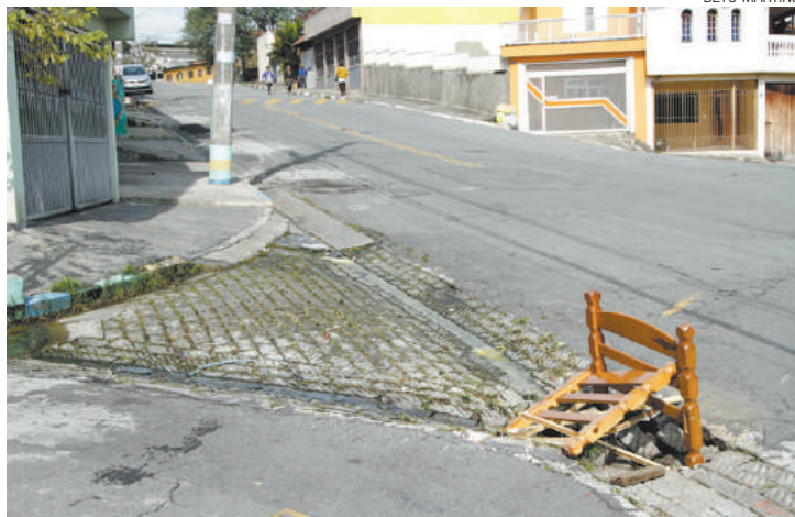
Afundando - Rua, casa e calçada são prejudicadas com o vazamento
