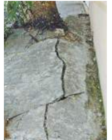
Perigo - Raízes quebraram a calçada e o tronco está inclinado
