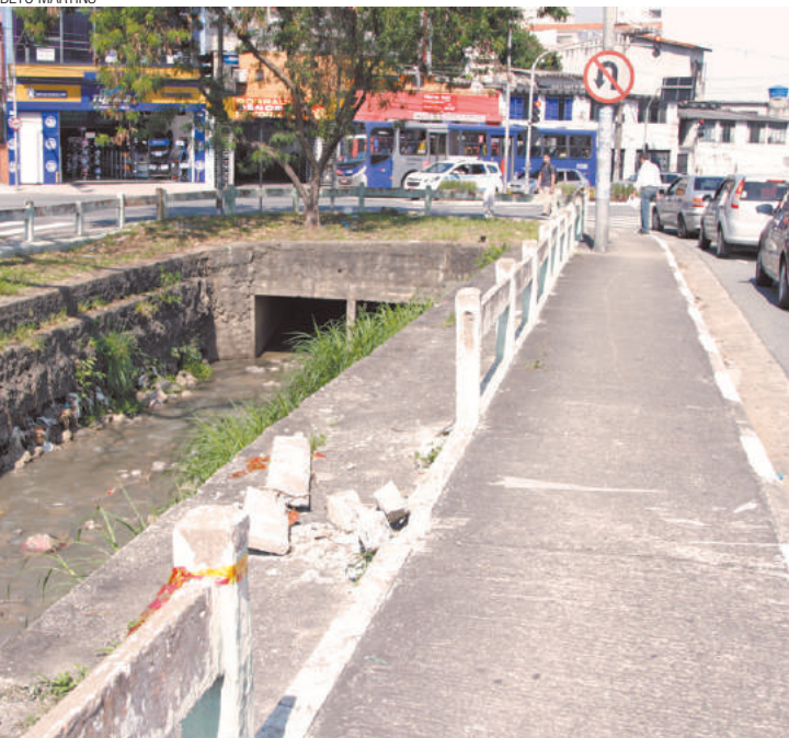
Quebrada - Além de problema com a grade, esgoto tem lixo e sujeira
