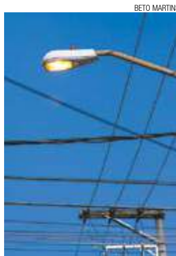
Resposta - Prefeitura informa que voltará ao local para nova vistoria
