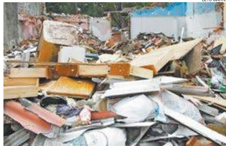
Escombros- Restos de móveis e sujeira estão amontoados no local
