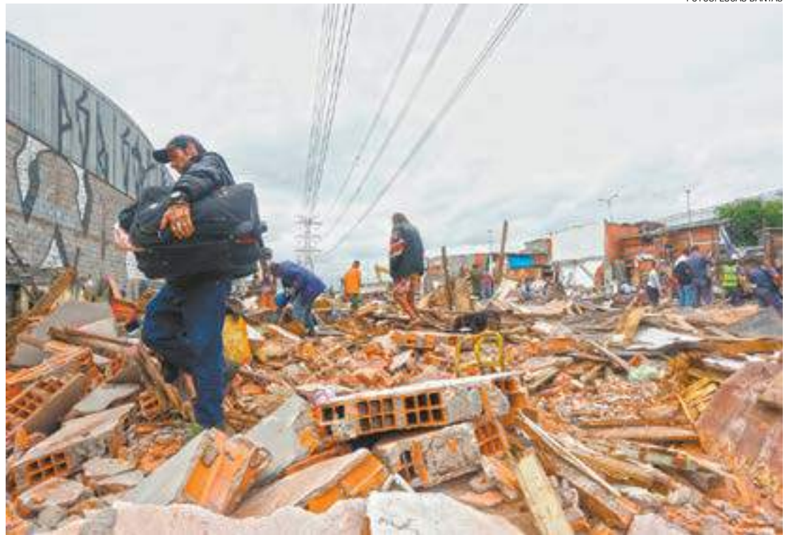
Destroços - Moradores retiram o que sobrou das casas em meio aos restos de concreto na manhã de ontem
