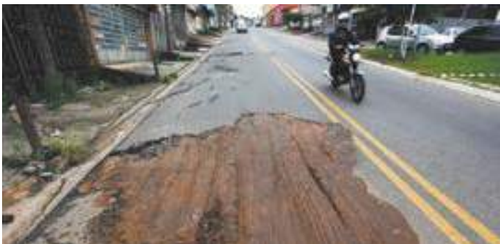
Dificuldade - Motociclista trafega na contramão pelo reparo malfeito
