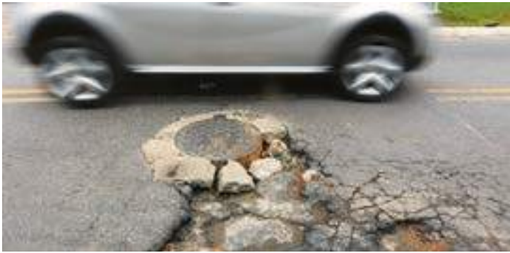
Perigo - Asfalto deteriorado ao redor da boca de lobo na Av. Nova América
