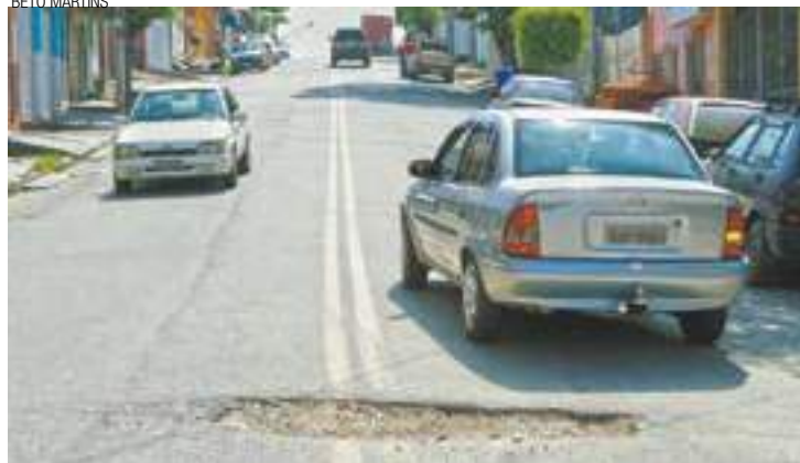
Obstáculo - Buraco ocupa os dois lados da pista e dificulta a circulação
