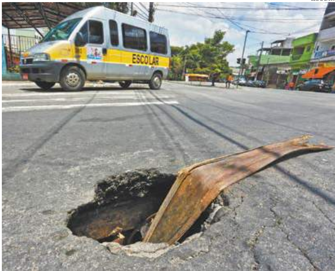
Na faixa - Cratera começa a tomar conta de parte de área delimitada para pedestres atravessarem a via
