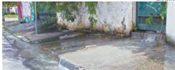
Nojo - Água suja, supostamente contaminada, escorre sobre a calçada
