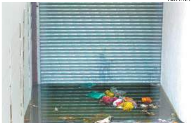
Perigo - Prédio com sinais de abandono na Rua Tapajós, no Macedo
