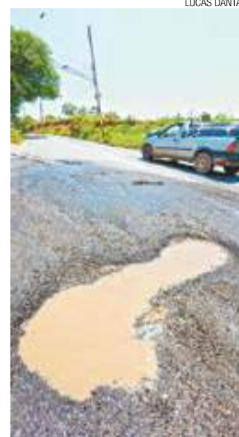
Descaso - Buracos acumulam água e já estão abertos há um mês
