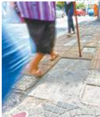
Perigo - Mulher utilizando uma bengala cruza piso tátil deteriorado
