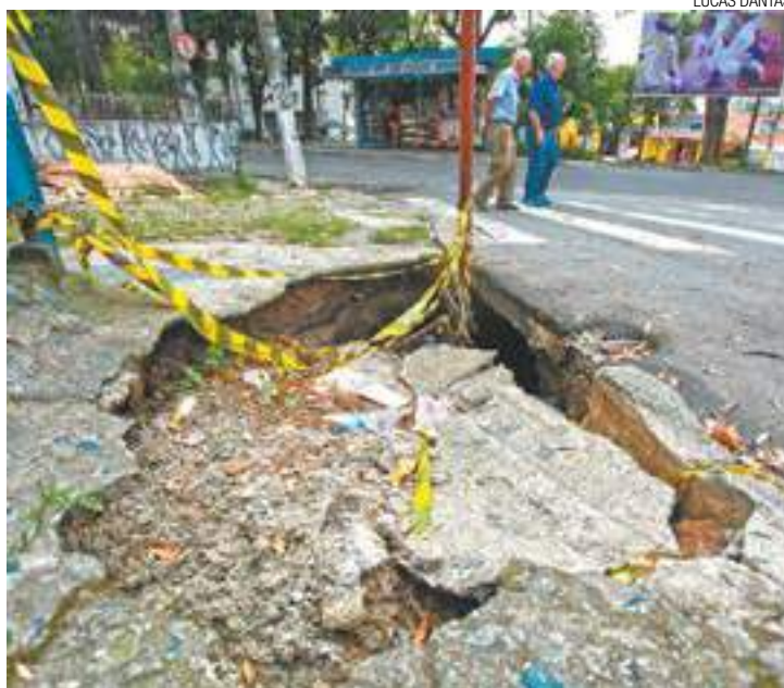
Estrago - Imenso buraco ocupa a calçada da Rua Antônio Iervolino
