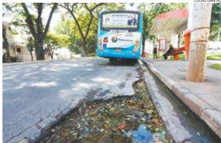
Ponto de ônibus - Trecho de asfalto cedeu e acumula água e folhas
