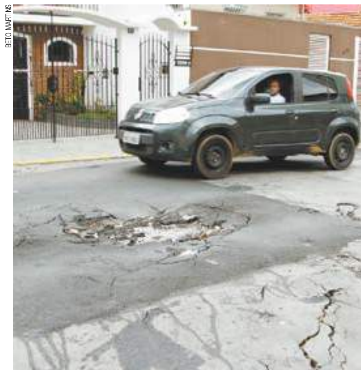
Ruim - Asfalto recente está cedendo e tem várias rachaduras na via
