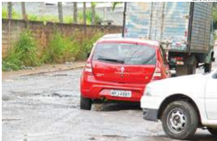
Buracos - Trecho na esquina da Av. Papa João Paulo com a Rua João Ranieri
