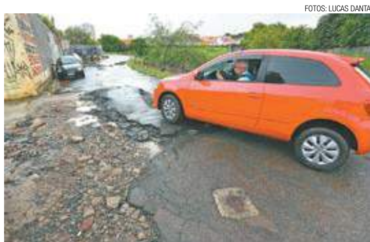
Deslocamento - Asfalto foi arrastado pela chuva na Vila Rio de Janeiro
