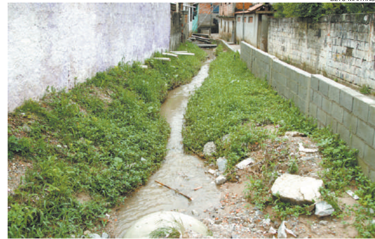
Problema - Cano do Saae, que precisa ser remanejado, impede os trabalhos
