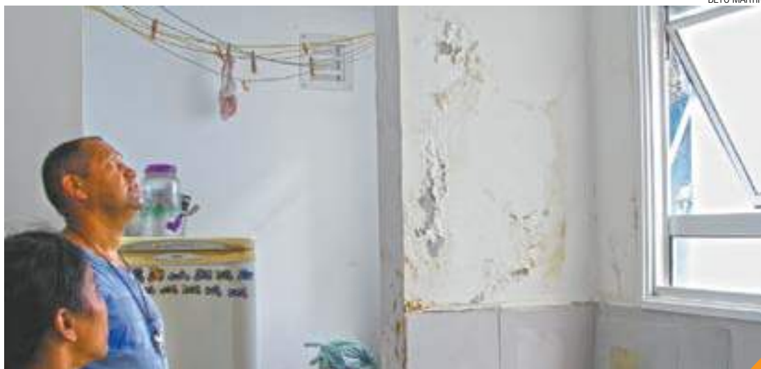
Problema - Valdemir Matias de Souza observa as paredes da cozinha com sinais de umidade
