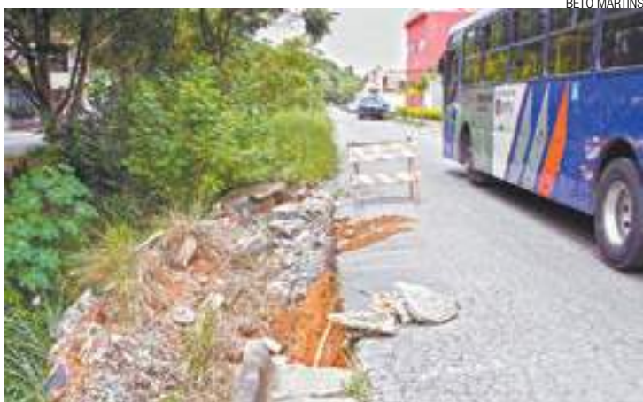
Perigo - Parte do asfalto e do muro de arrimo desabaram no córrego
