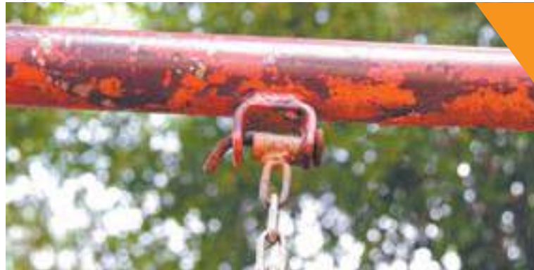
Falta manutenção - Equipamentos expostos ao tempo estão desgastados
