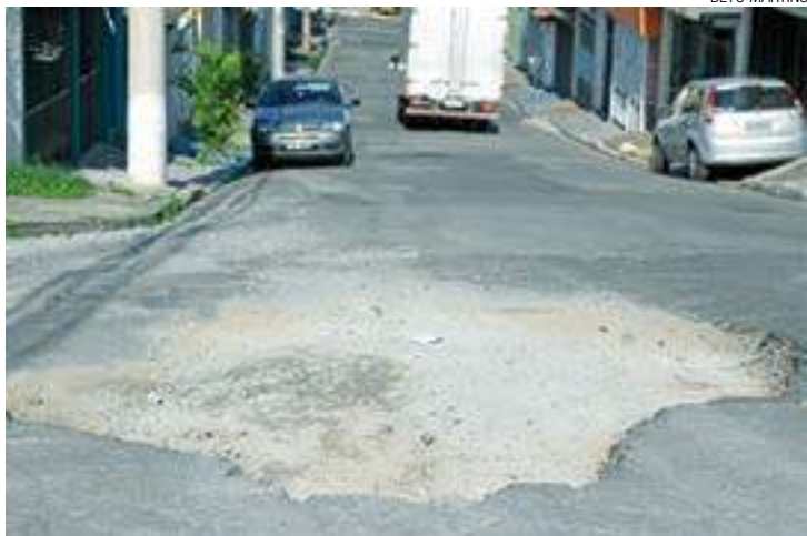
Cratera - Abertura ficou exposta após conserto de vazamento do Saae
