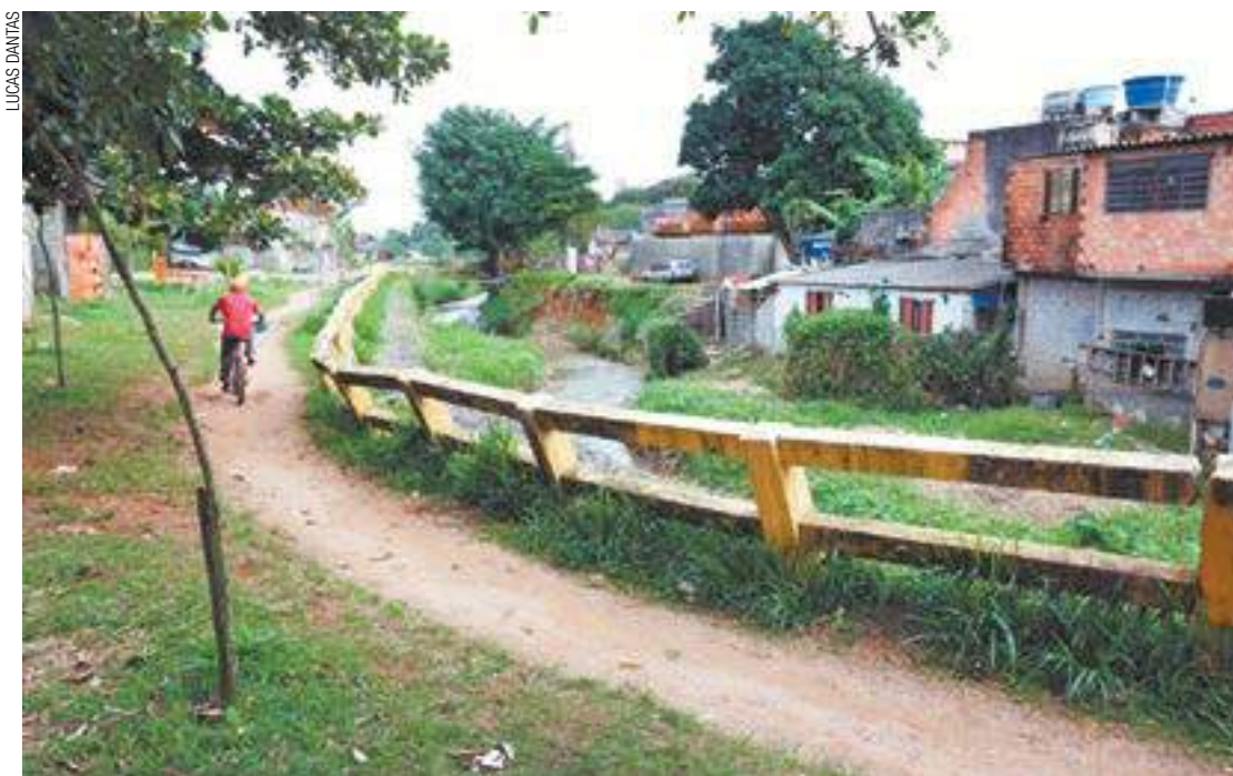
Risco iminente - Ciclista cruza trilha de terra ladeando mureta de proteção que está prestes a cair no córrego
