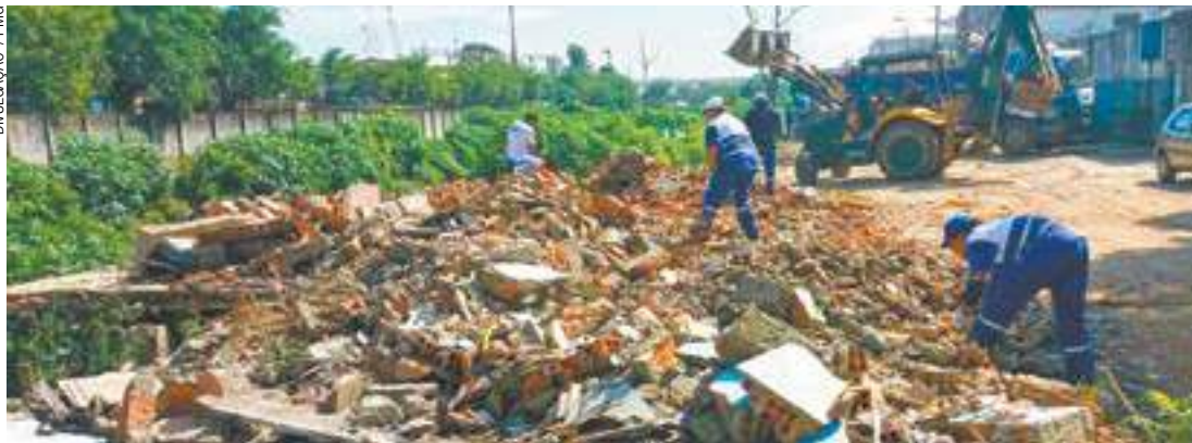
Volume - Operários removem amontoado de entulho com a ajuda de retroescavadeira na Avenida Baquirivu
