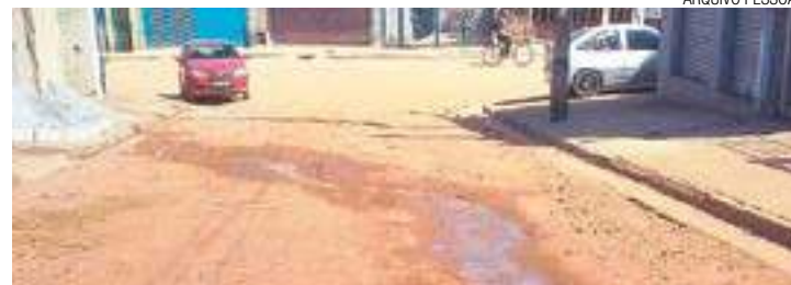
Lama - Água começou a vazar no meio de uma rua de terra no Bambi
